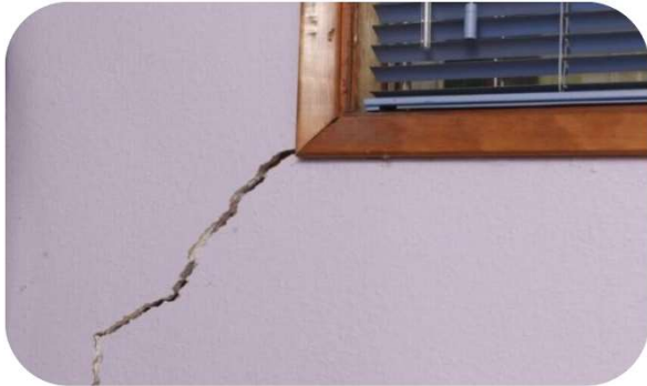
Dommmages sur nos infrastructures
